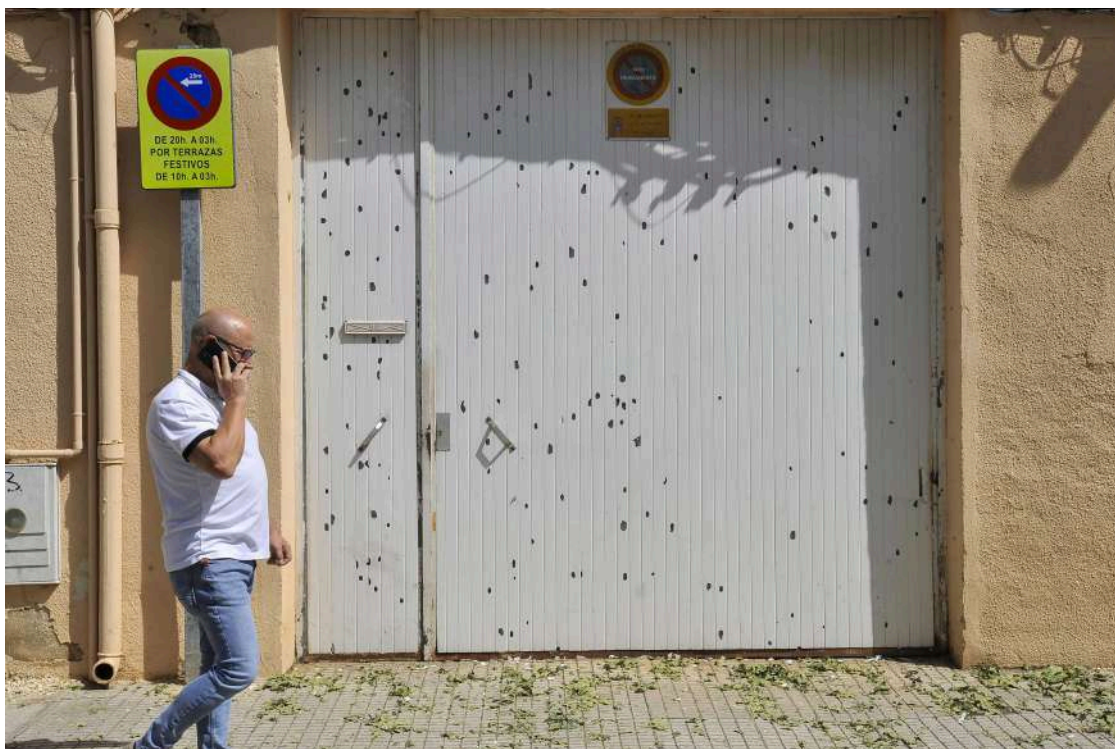
Puerta de un garaje agujereada por la tormenta de granizo que cayó en La Roda (Albacete). EFE/ Manu
